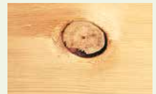
Simpul yang Tidak Terpasang dengan Kuat
